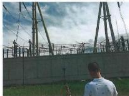
盐海 220kV 变北
