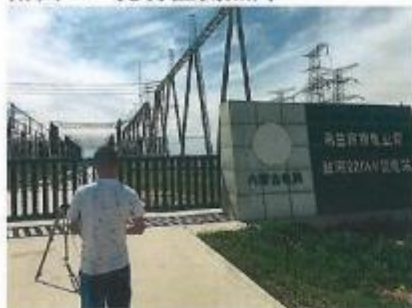
盐海 220kV 变东
