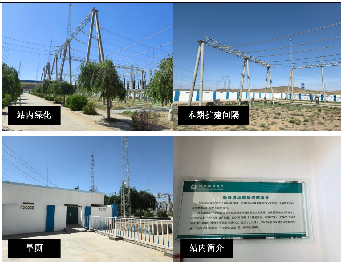
图 2-2 获各琦 220kV 变电站站内实景
