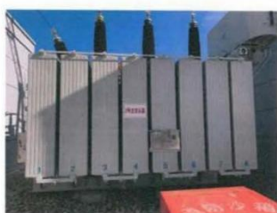
锦和变电站 2#主变
