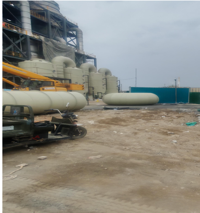
拟建变电站西侧 厂内副产品车间及室外蒸发器设备
